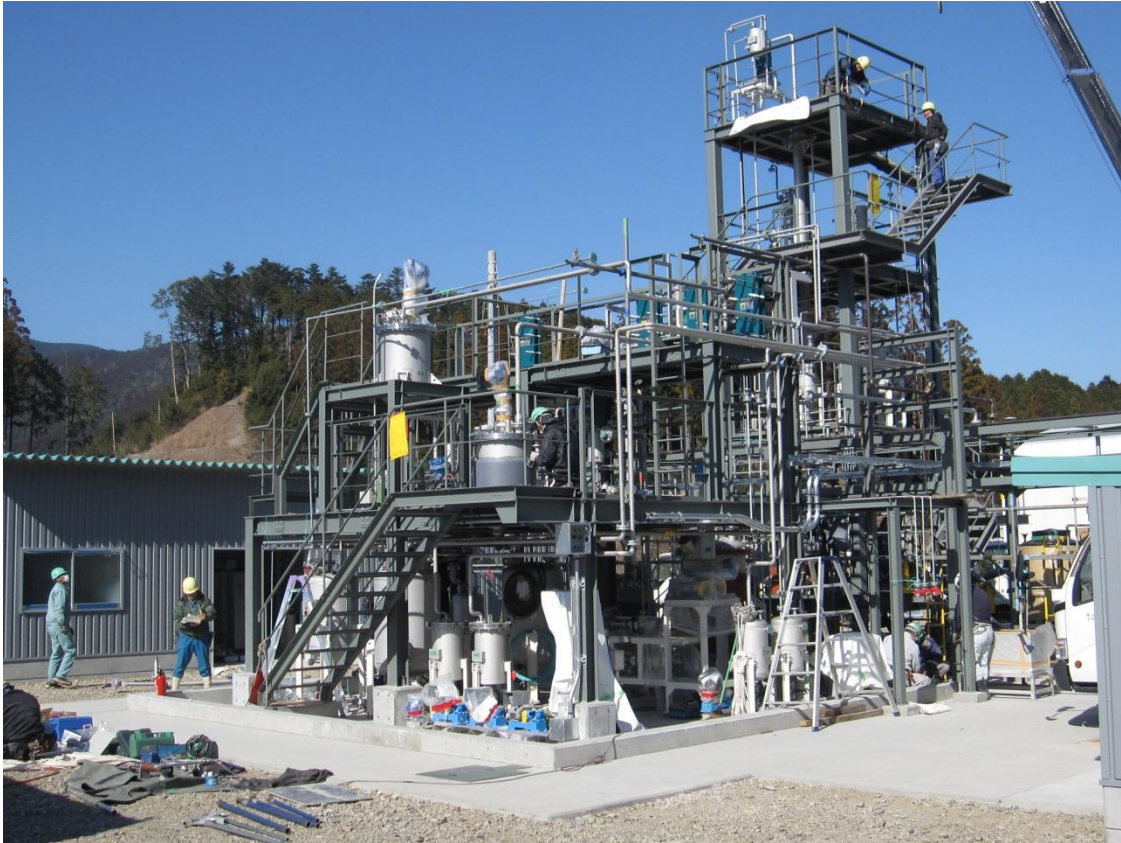
Kuva 4. IV-tyyppin lignofenolitehtaan pilotti (Funaoka 2012)
